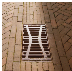
Offene Rinne mit gußeisernem Einlauf
